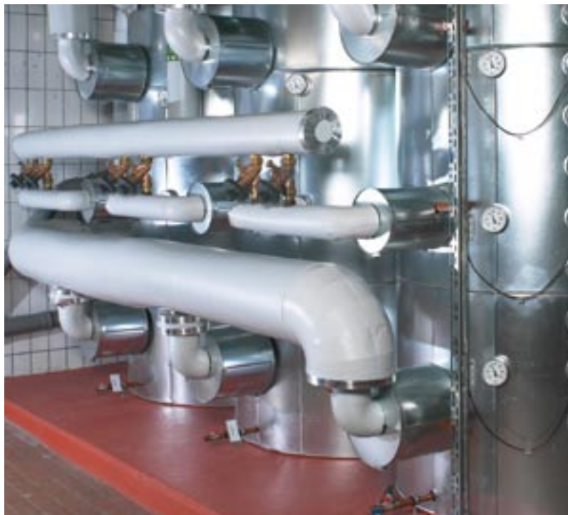
Mehrere Kilometer lang ist das Rohrleitungsnetz des Nahwärmeverbundes auf dem Hebronberg.
