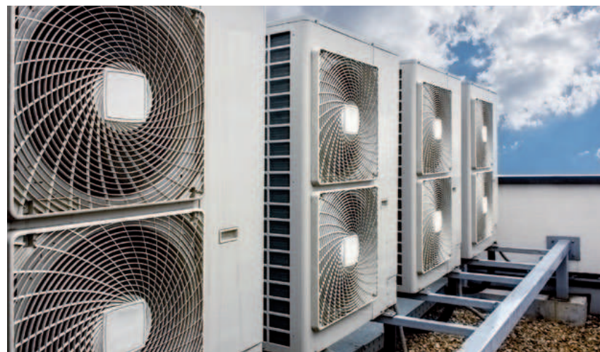
Kilowattstunde für Kilowattstunde, Euro für Euro: Krankenhäuser blasen die wertvolle Abwärme Ihrer Kälteanlagen oft ungenutzt vom Dach in die Umwelt.
